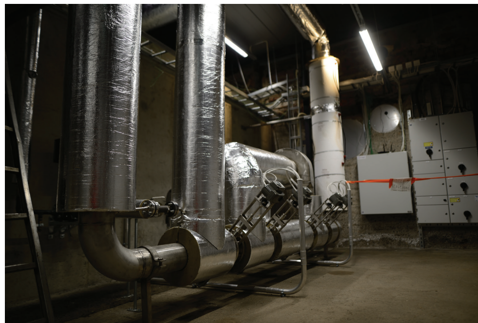
図7 フィンランドのTempereにあるPolar Night Energyが設置した熱伝達システムの一部。左側の垂直パイプは熱交換器の一部で、右側の白い抵抗発熱体は白い断熱材に包まれています。これらの部品の間にあるのが、空気循環式のラジアルブローです。
